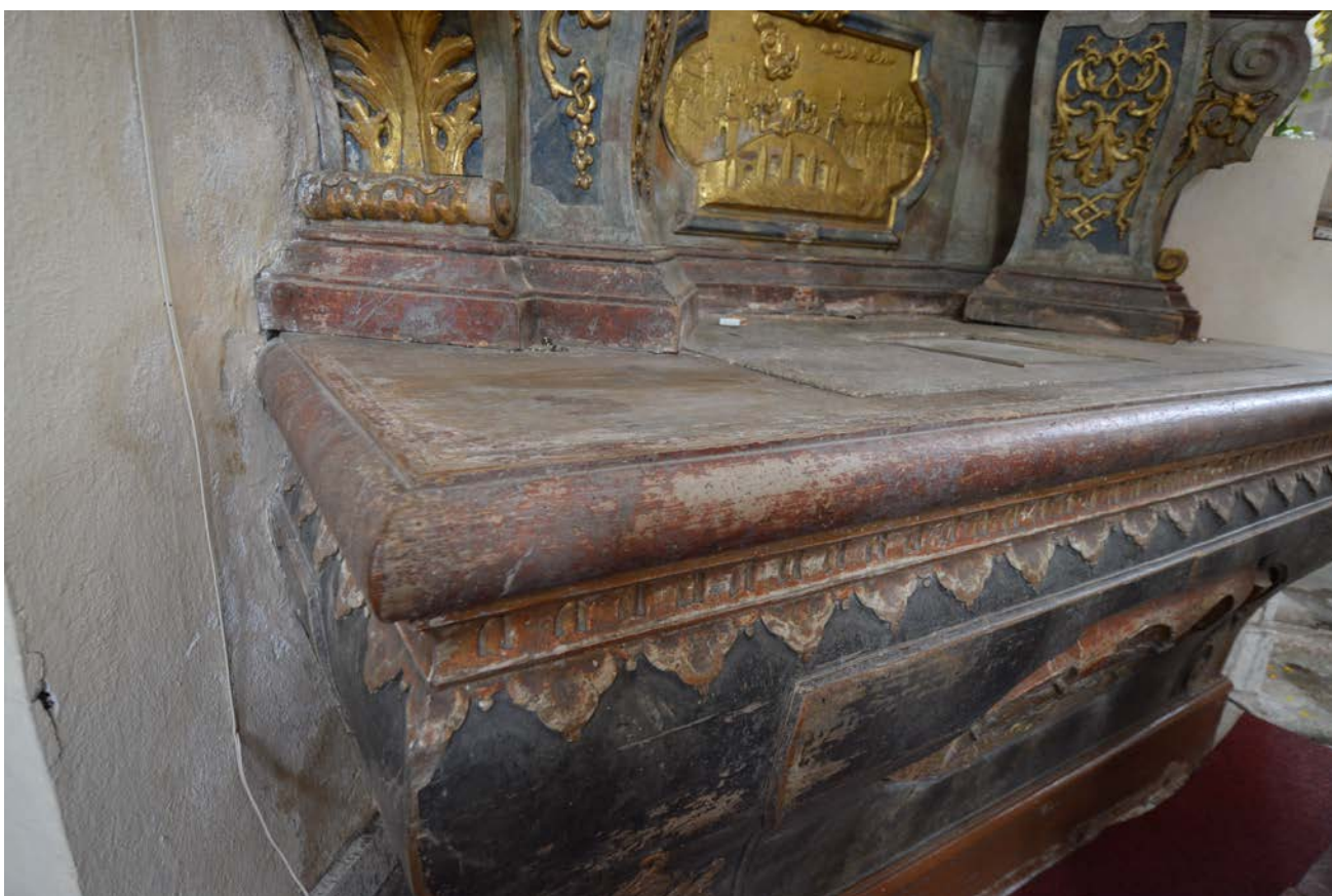
8/ detail architektúry oltára, havarijný stav, aktívny červotoč
